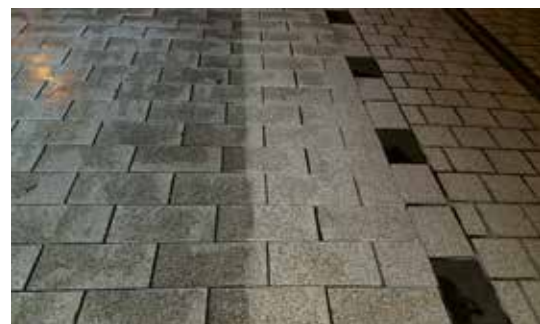
Het lijkt schaduw, maar het is vies. Rechts is het schoon.
