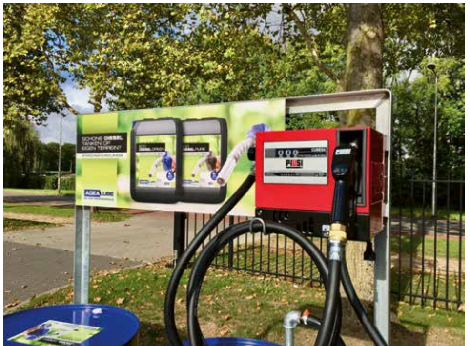
Duurzame brandstoffen zijn vaak niet aan de pomp verkrijgbaar. Steeds meer leveranciers proberen daarom eigen oplossingen te ontwikkelen voor opslag en tanken op eigen terrein of op de werklocatie.
