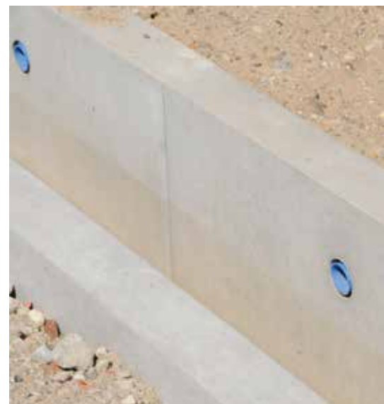
Springen in de kabelgoten
