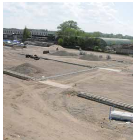
Bovenaanzicht van de parking in aanleg waar de groeiplaatsen voor de bomen al zijn aangebracht
