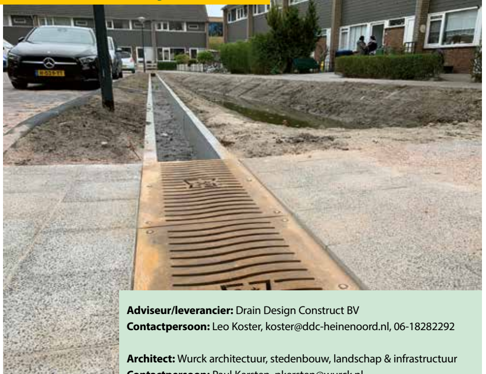
Het water wordt vanuit een hemelwaterstelsel opgepompt en stroomt via de "brievenbus" in de opvoerput uit in de goot.
